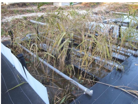
写真 6 散水管から湿地へ処理水が流入
